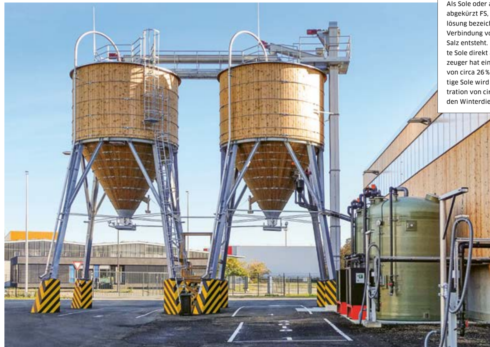
Silo- und Soleanlagen, Werkhof Baubetriebshof Köln AWB
